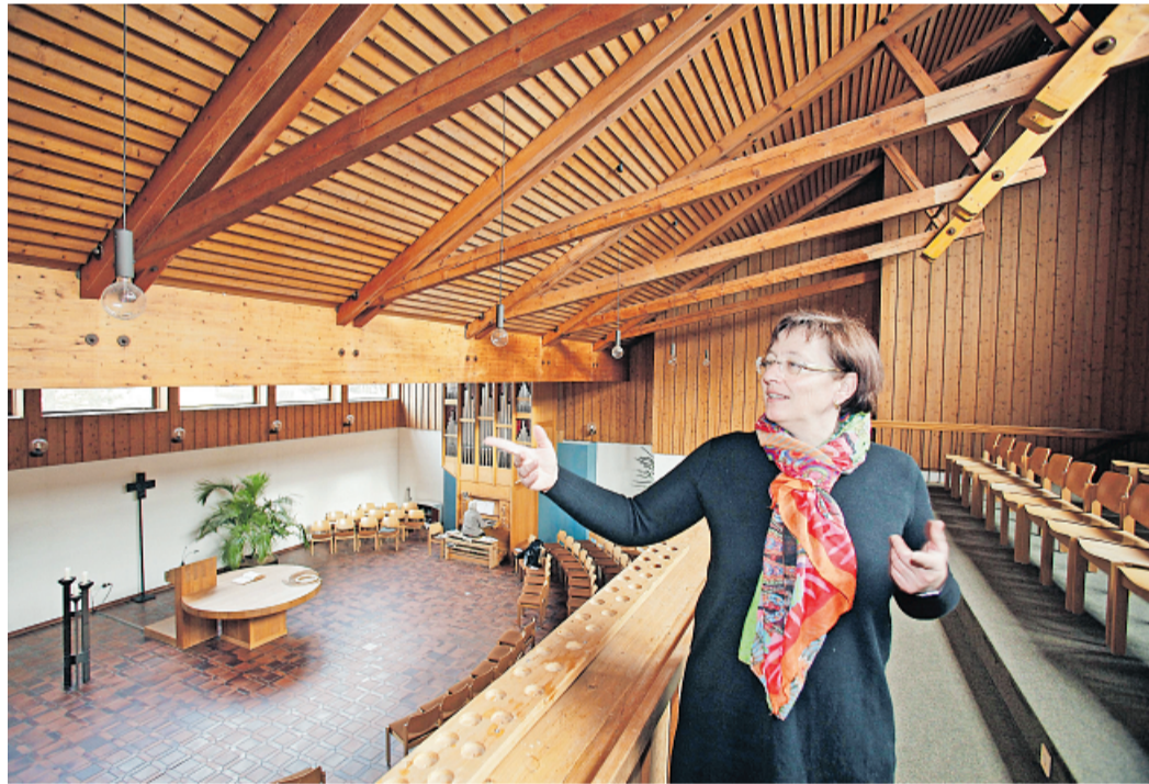
Pfarrerin Beate Kimmel-Uhlendorf zeigt auf die Balken und Holzverkleidungen in der Worzeldorfer Osterkirche, die mit PCB belastet sind und demnächst saniert werden. Foto: Michael Matejka
